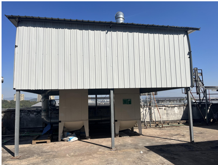
图 3-8 喷塑废气处理设施现场照片
