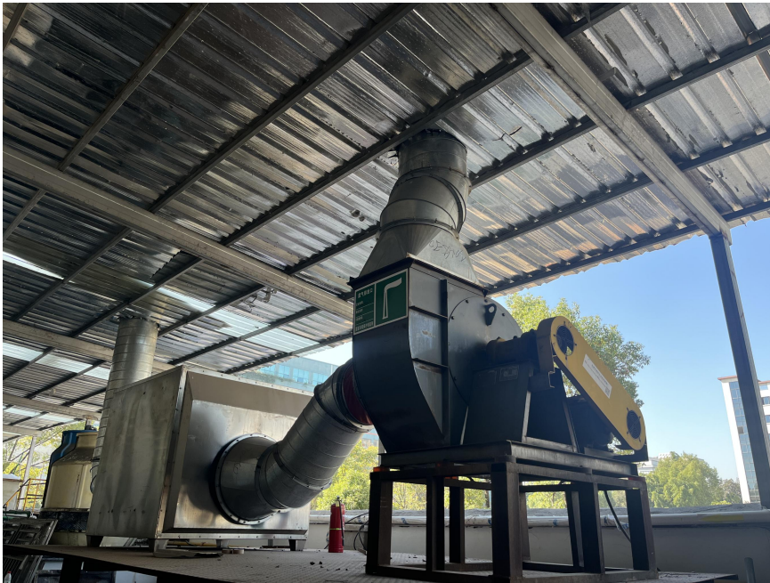
图 3-12 注塑废气处理设施现场照片
