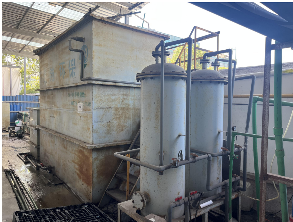
图 3-3 废水处理设施现场照片
