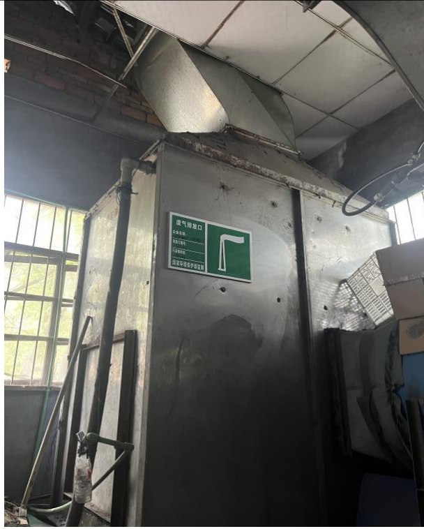
图 3-6 抛光废气处理设施现场照片
