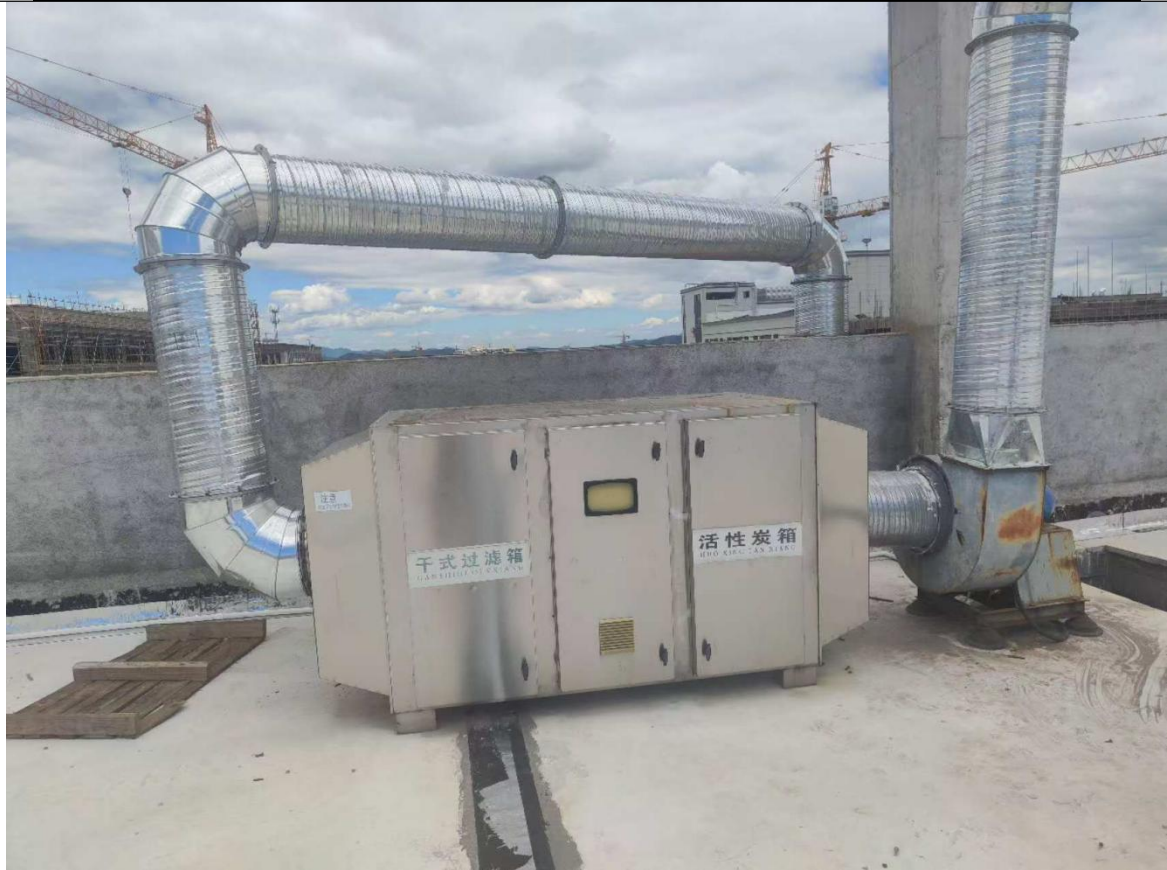
图 3-3 印刷废气处理现场图
